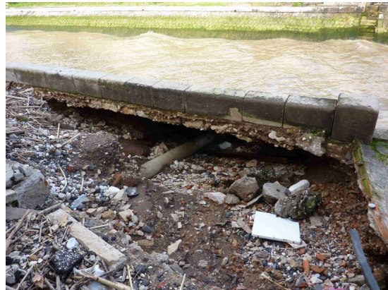
Figura 48 – Erosão do leito de cheias na margem direita do rio Jamor entre a ponte da Av. Marginal e a ponte da REFER - vista para montante
