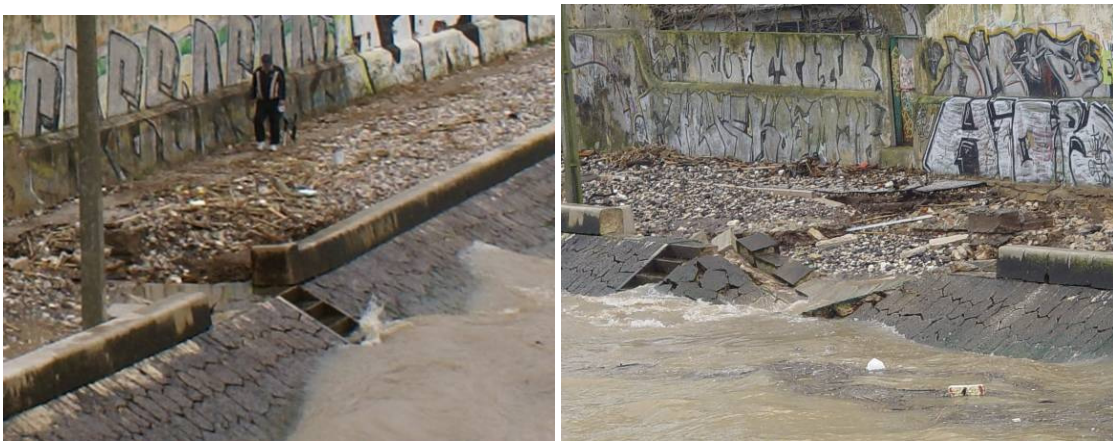
Figura 81 - Inundação e destruição das margens de protecção do Rio Jamor, foto à esquerda no dia 24 de Fevereiro de 2010 e foto à direita no dia 27 de Fevereiro de 2010 (Fonte: GEOTPU)
