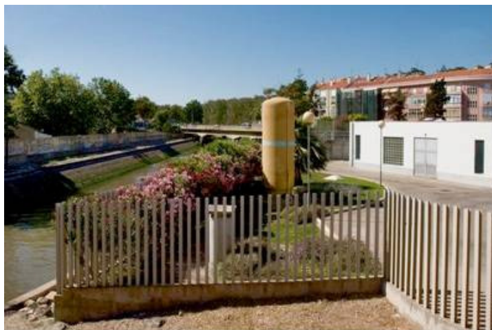
Figura 96 – Estação Elevatória do Jamor (Fonte: sítio – SANEST)
