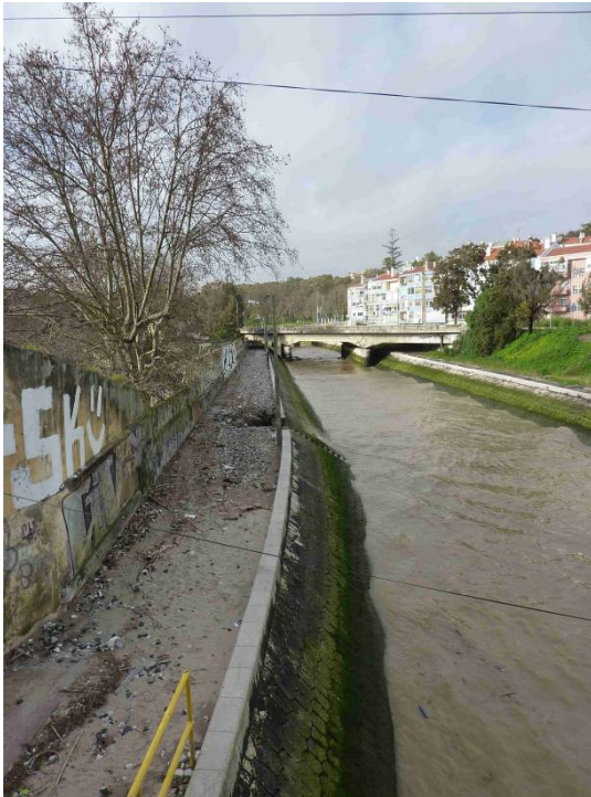
Figura 47 – Leito de cheias na margem direita do rio Jamor entre a ponte da Av. Marginal e a ponte da REFER - vista para montante
