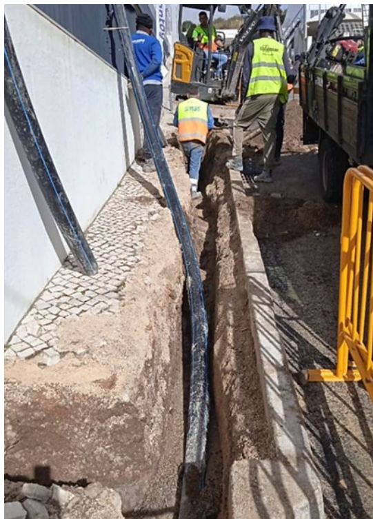
Substituição das redes de abastecimento de água na Quinta do Paizinho - Carnaxide - Oeiras
