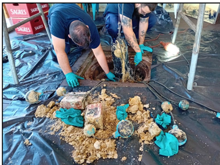
Retirada das eletrobombas para desobstrução e limpeza dos impulsores e das boias de comando para limpeza, e limpeza do poço na Estação Elevatória do Bar da Marina de Oeiras
