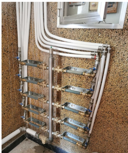
Contadores instalados em bateria
