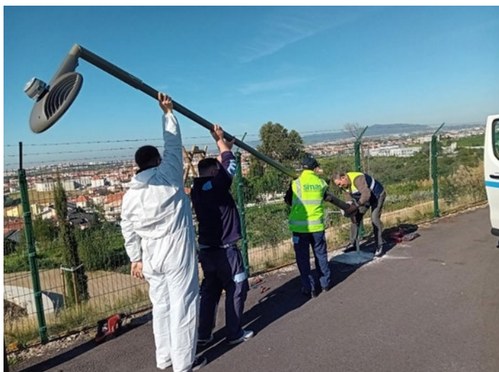
Substituição da iluminação exterior no recinto do Reservatório de Porto Salvo
