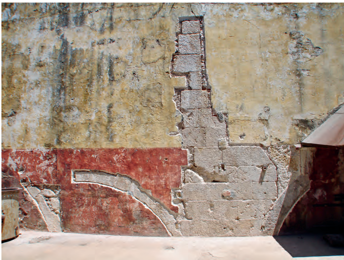
Fig. 3 – Ferrarias del Rey . Picagem de rebocos na parede externa do lado ocidental do edifício, realizada em 2007, identificando-se o cunhal de alvenaria aparelhada correspondente ao limite do edifício anteriormente ao acrescimento realizado no final do século XVIII sob a égide de Bartolomeu da Costa.
